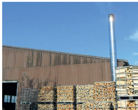
Centrale de chauffage à distance.
