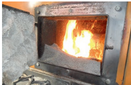
Foyer et dépôt de cendres dans une chaudière à bois.
