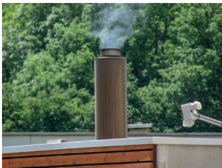
Cheminées d'une chaudière à bois de petite puissance (110kW).
